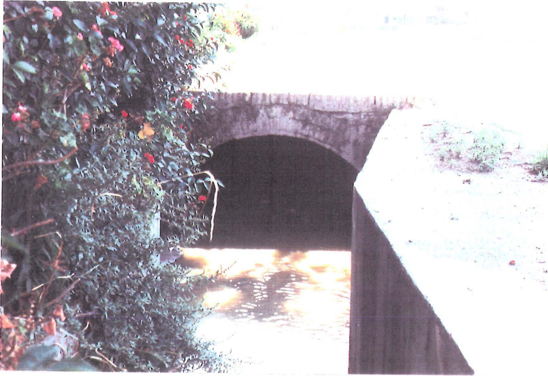
Plate 3.8: Site VH, sanitary wastewater sewer at Las Fuentes, Valencia.
