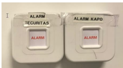
Abbildung 5: Alarmknöpfe (Quelle: Eigenes Foto)
